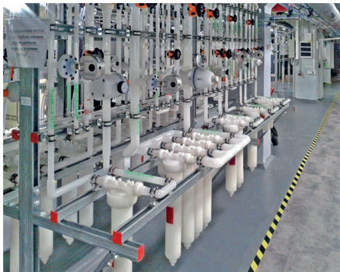
Рис.5. Вид узлов подключения деионизованной воды для установок химической обработки
